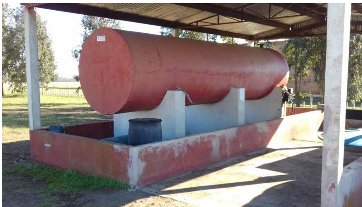
Tanque de combustível com bacia de contenção
