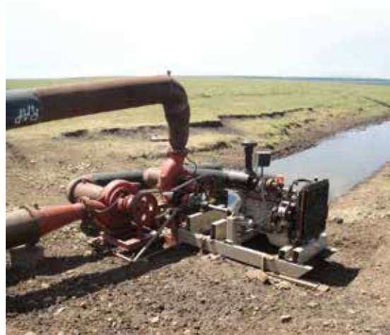
Estação de bombeamento no sistema diesel.
