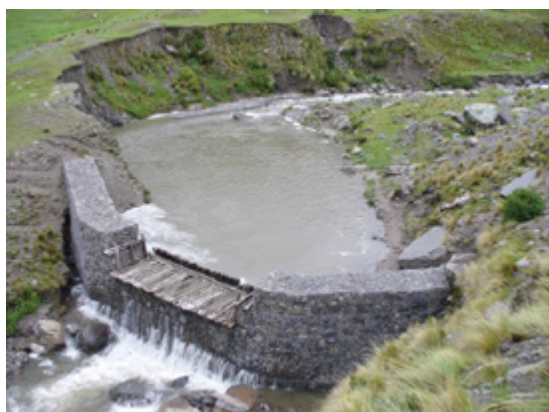
Control hidráulico en cauces principales.
