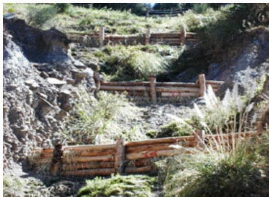
Estructuras con diques de madera.
