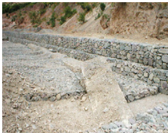
Defensas marginales sobre el río Colanzulí.
