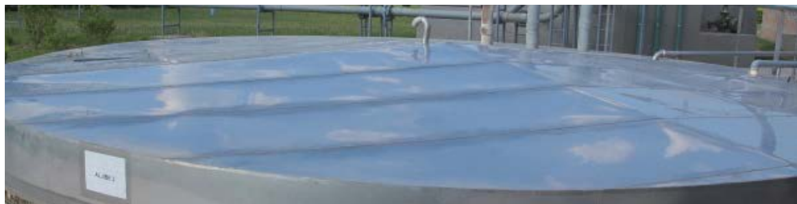
Plata potabilizadora de agua, comunidad menonita Filadelfia, Paraguay.
